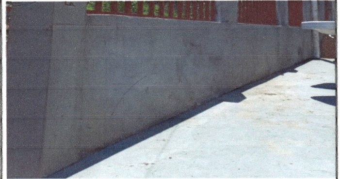
Foto 2: MODULO 1 MURO Reparación de muro perimetral de block con soleras intermedias y columnas
